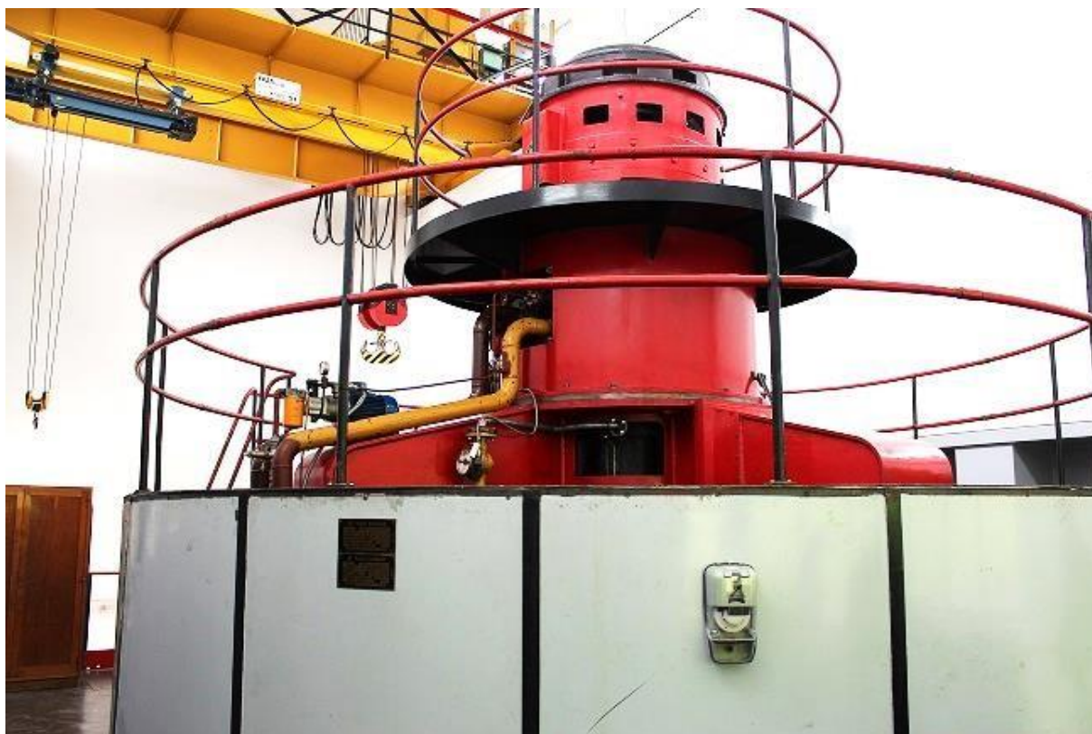
Slika 1.1.-2. Postojeći motor/generator na CHE Fužine
